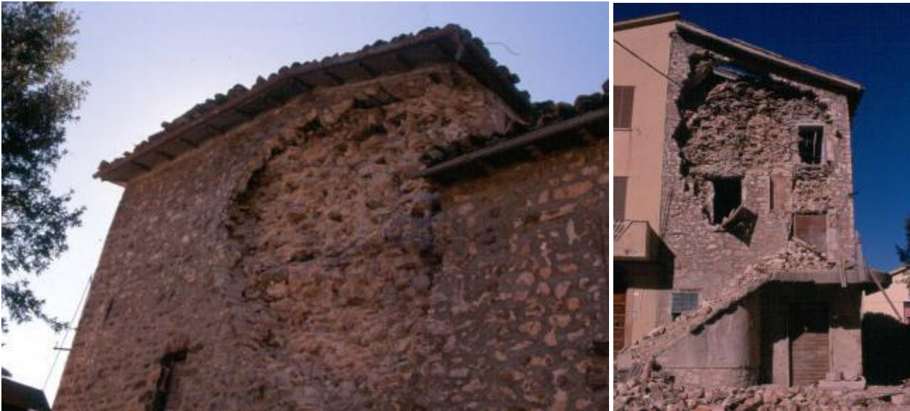
Figura 35 - Disgregazione nella muratura a sacco
